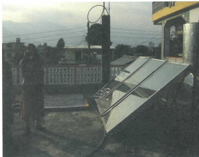
Les plaques solars permeten tenir aigua calenta en el centre
